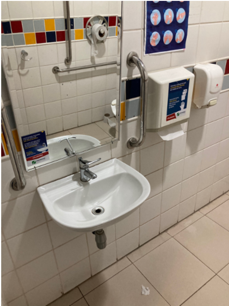
Pia do sanitário acessível
